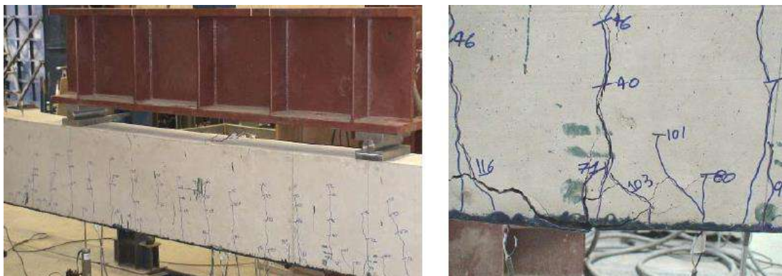
Figura 1.8 – Fissuras em uma viga após ensaio experimental em laboratório. [5]
